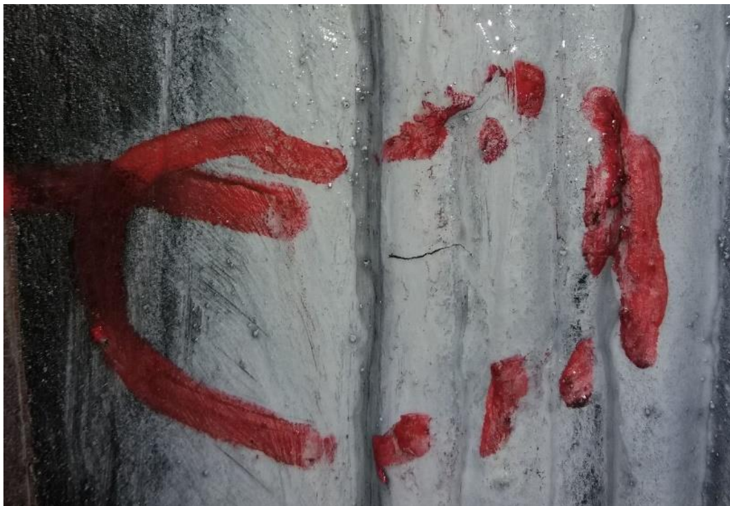
KUVA 6. Magneettijauhetarkastuksella löytnyt halkeama hitsissä (Kallio V. 2018)
