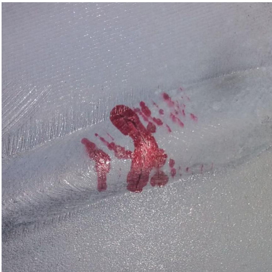
KUVA 3. Värillisellä tunkeumanestetarkastuksella löydetty halkeamia (Kallio V. 2018)
