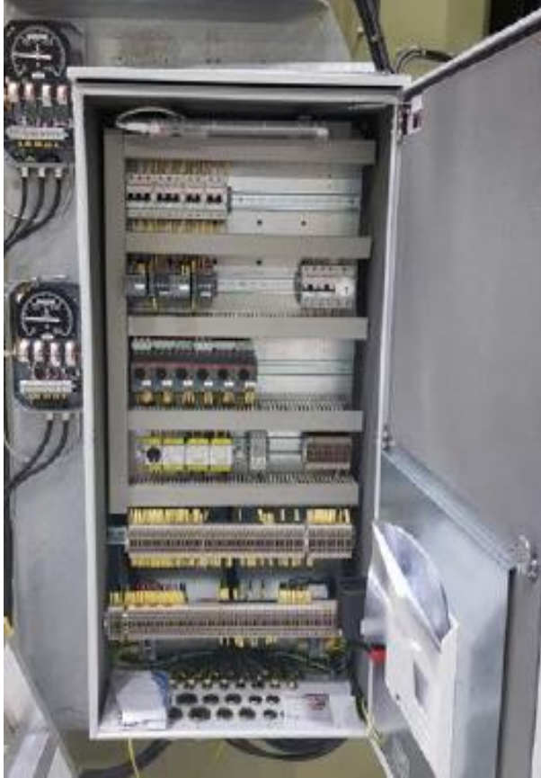
Kuva 23. Uusittu apuohjaus kaappi (29.8.2018.)
