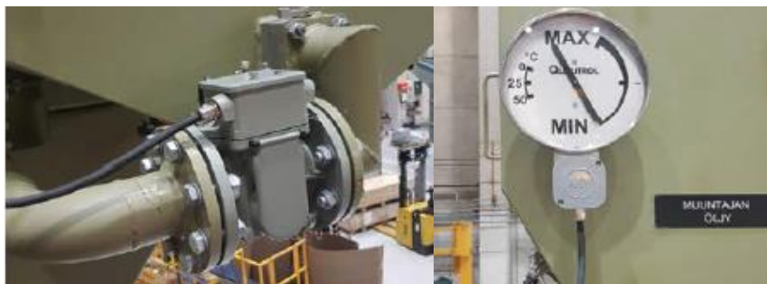
Kuva 24. Uusittu kaasurele ja uusi öljyn korkeus- ja lämpöanturi (29.8.2018.)
