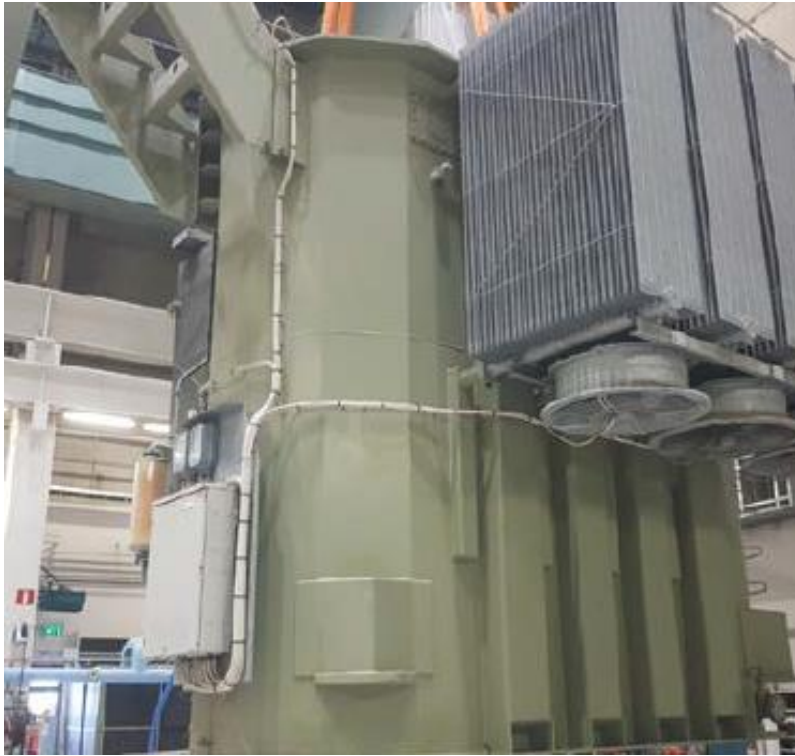
Kuva 12. Muuntaja Vaasassa ABB:n huoltopaikalla (29.7.2018.)
