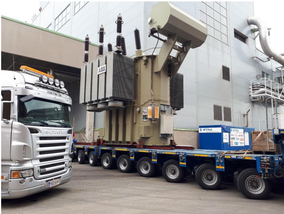
Kuva 11. Muuntaja lavetilla valmiina kuljetukseen (25.7.2018.)
