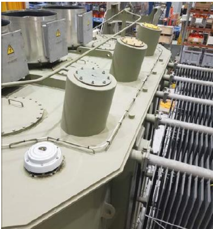
Kuva 14. Kuva muuntajan kannelta (29.7.2018.)
