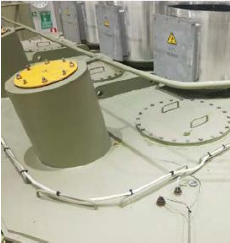
Kuva 13. Kuva muuntajan kannelta (29.7.2018.)
