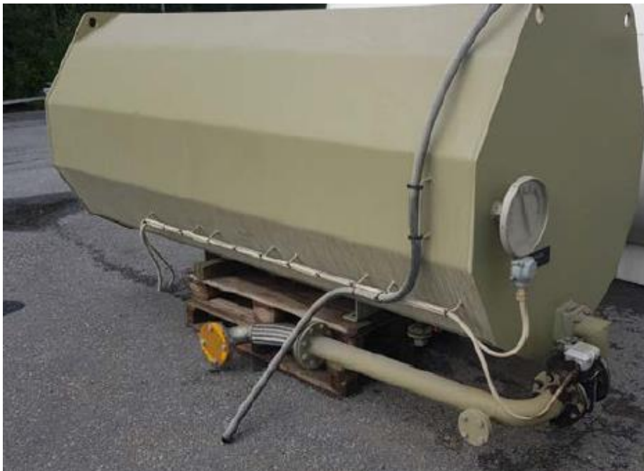
Kuva 16. Muuntajan paisuntasäiliö varusteineen (30.7.2018.)
