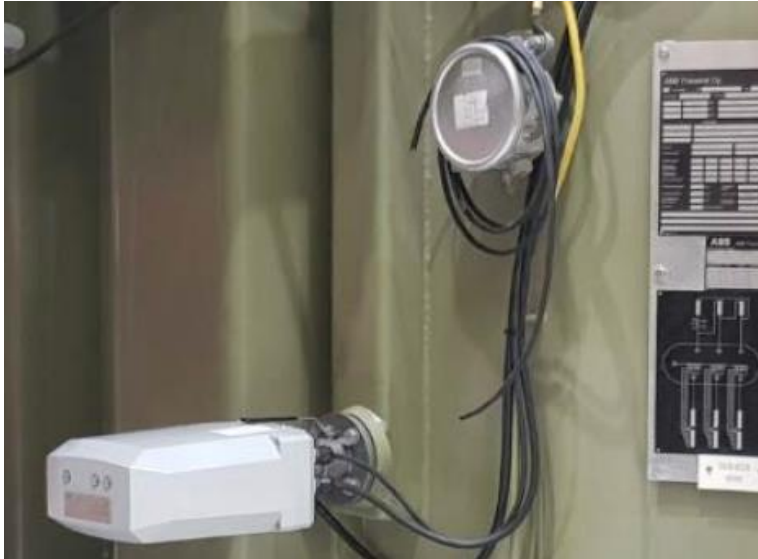
Kuva 25. Lisätty kaasuanalysointilaite Core Sense, asennuspaikka radiatorin alaputkessa (29.8.2018.)
