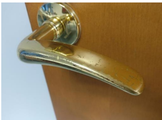
Kuva 1. Kulunut märkälakattu painike (Pekkonen 2019-01)
