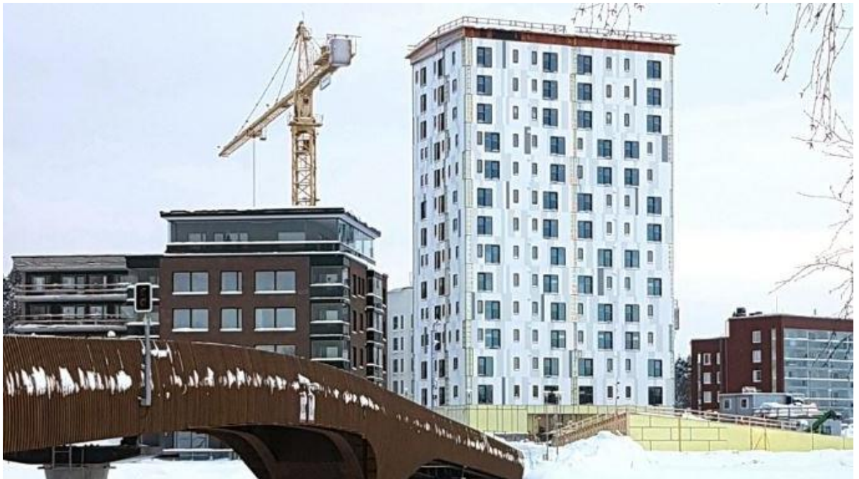
KUVA 6. Light House Joensuun rakennustöiden aikana suojana on väliaikainen katto, joka nostetaan pois paikalta, kun elementit asennetaan (Karelia.fi)
