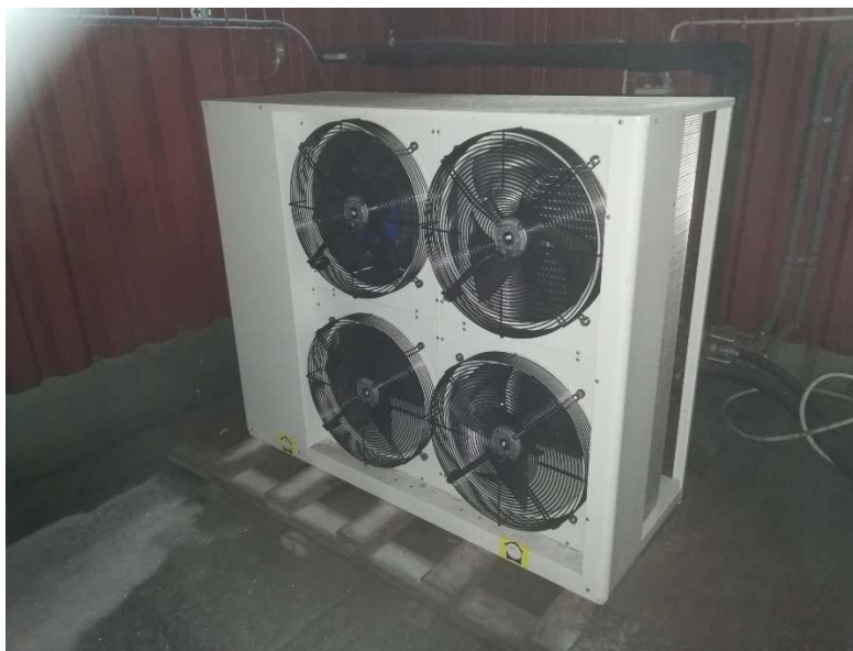
KUVA 5. Jäähdytyskoneikko (Savon Voiman valvomo)
