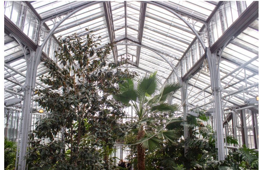
Kuva 67 Helsingin Talvipuutarhassa on kauniit teräsrakenteet. Korkeassa tilassa on myös palmujne täyttämäs keidasalue. Kuvattu 8,3,2019.
