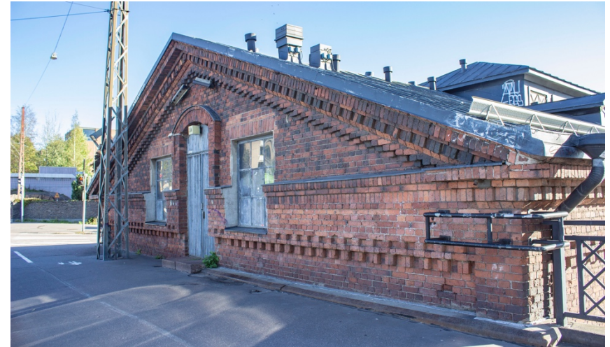
Kuva 35 Sörnäisten Kruununmakasiinin länsijulkisivulla oleva Hämeentien sillan sisäänkäynti. Ikkunat on vaihdettu vankilan käytön aikana suorakaiteen mallisiin ikkunoihin ja samalla edeltävien ikkunoiden koristeakaaret on poistettu. Kuva otettu 24.9.2018.
