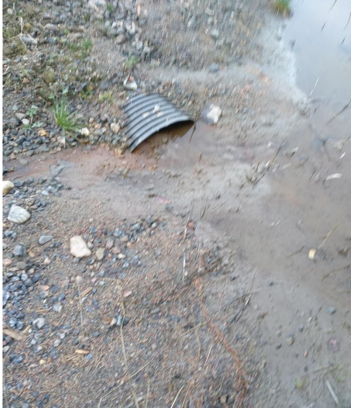
KUVA 6. Tukkeutunut rumpu estää veden liikkumisen (Linna, 2018)
