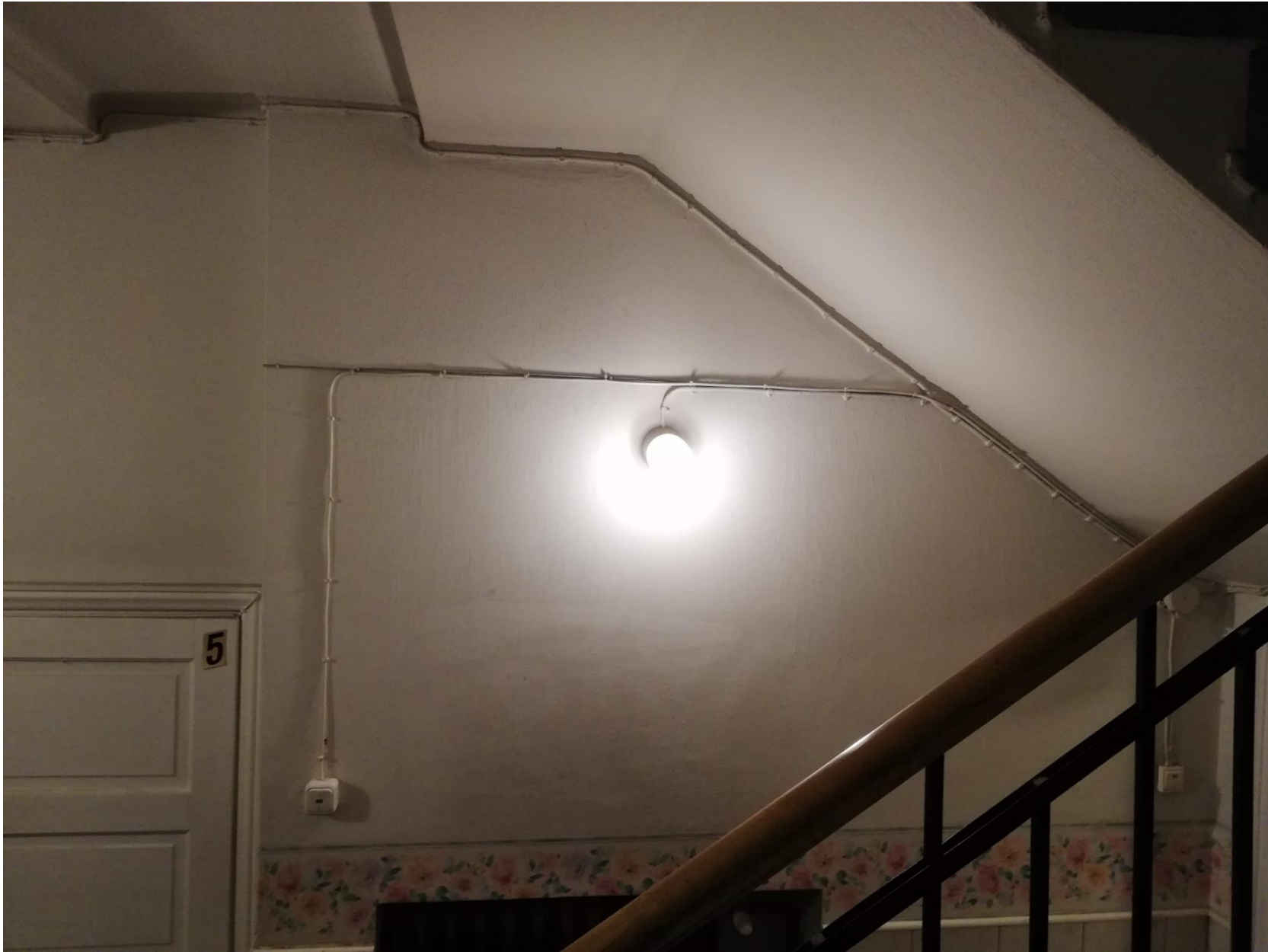
Kuva 9. Ensimmäisen kerroksen sähköt ja valaistus.
