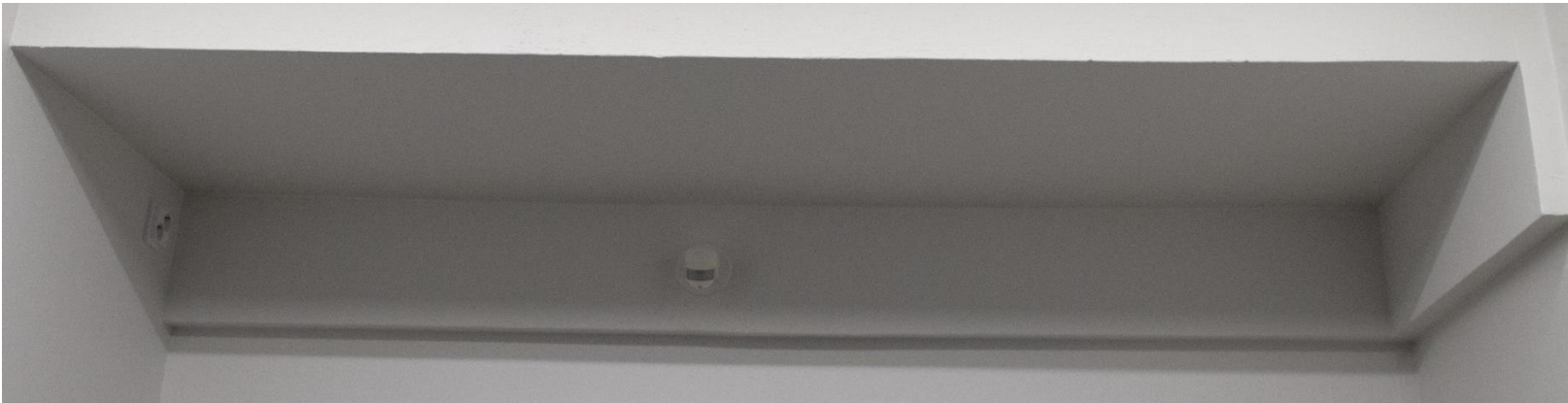
Kuva 26. Ensimmäisen kerroksen sähkökoteloinnit.
