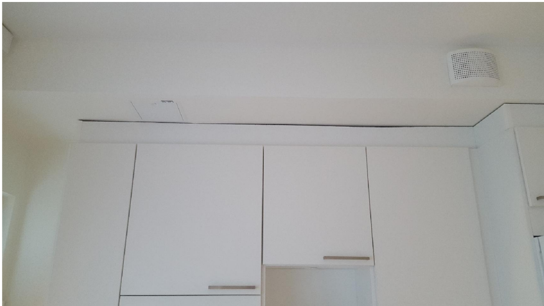
Kuva 2. Ylätäyttö on tehty huonosti.
