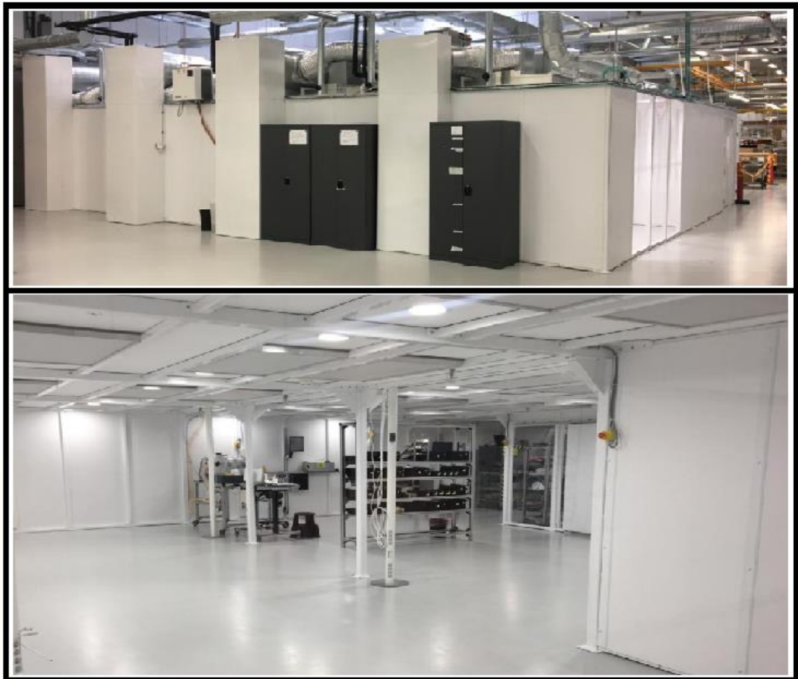
Kuva 5. Tuusulan tehtaalla modulaarinen partikkelikontrolloitutila. Yläpuolella kuva tilasta ulkoapäin ja alapuolella kuva rakennusvaiheessa olevasta sisätilasta.
