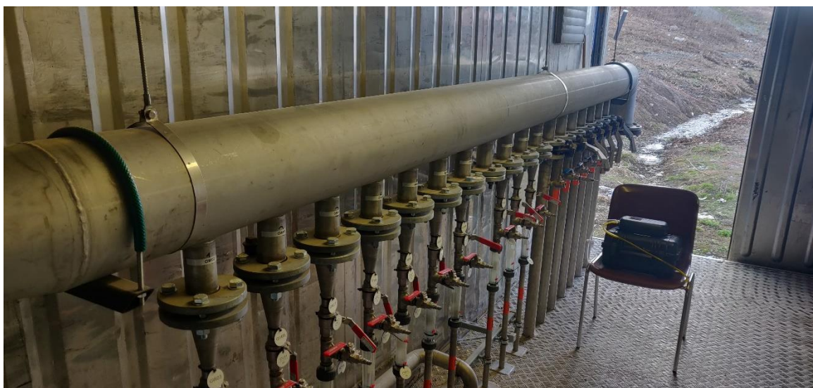
KUVA 6. Kaasun keräysputket kaasupumppaamossa (Karjanmaa 2019-9-5.)
