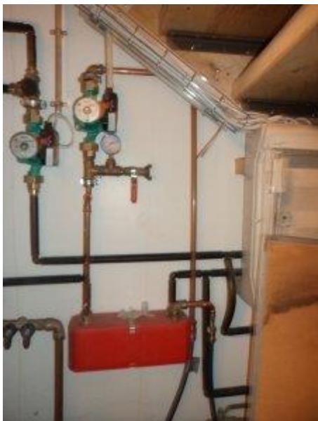
KUVA 5. Wiknerin Ratsutilan vesikiertoinen lämmitysjärjestelmä (Hippolis, 2019)
