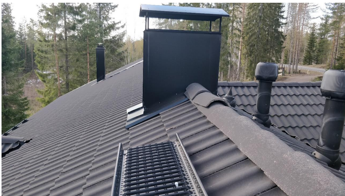
Kuva 12. Puutteellisista kattoturvatuotteista on raportoitava tilaajalle välittömästi (Nissinen 2019-05-05)
