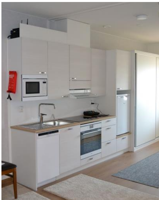
Kuva 12. Kiinteäkalusteinen keittiö, jonka tasolla SHX-järjestelmän hallintalaitteet ja keittiökaappien yläpuolella järjestelmän keskusyksikkö.
