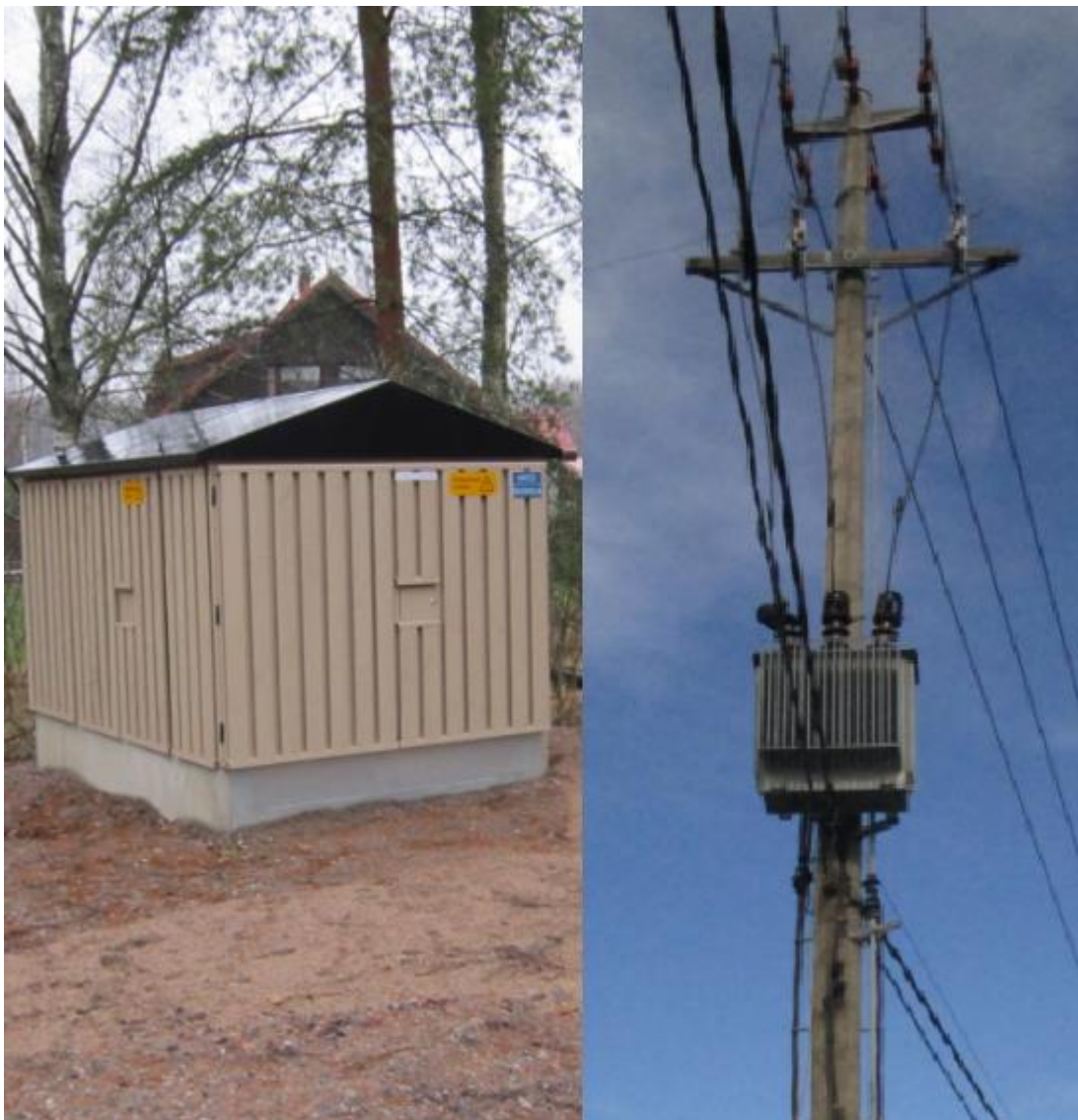
Kuva 8. Kuvassa vasemmalla on yleiskuva Keravalle sijaitsevasta puistomuuntamosta ja oikealla pylväsmuuntamosta.
