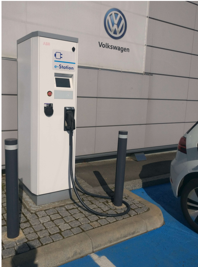
Kuva 9. ABB Terra 53CT -latausasema
