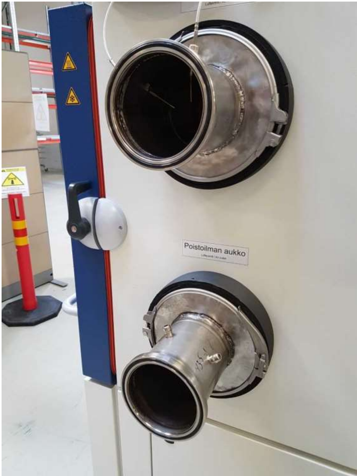
KUVA 7. Esimerkkitapaus kaappiin asennettavista laipoista
