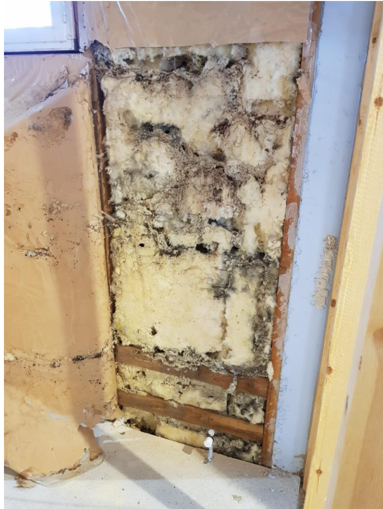
Kuvio 5. Pilaantunutta eristettä seinässä (Korjonen, A. 2019)
