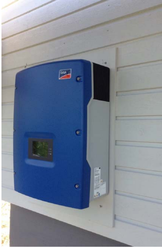
Kuva 8. Ulkoseinään asennettu ketjuinverterri [7].
