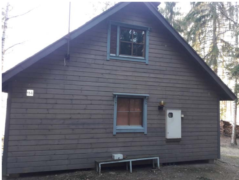
Kuva 13. Päärakennuksen ajotien puoleinen seinusta, jolla sijaitsee pääkeskus.
