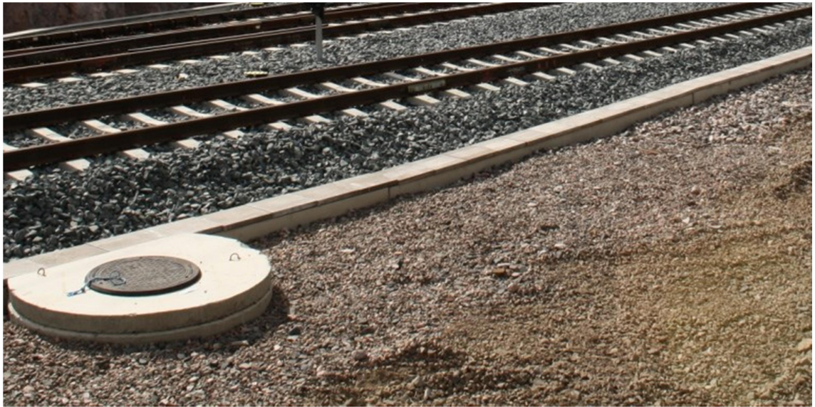
Kuva 1. Kaapelikanava ja -kaivo (3).
