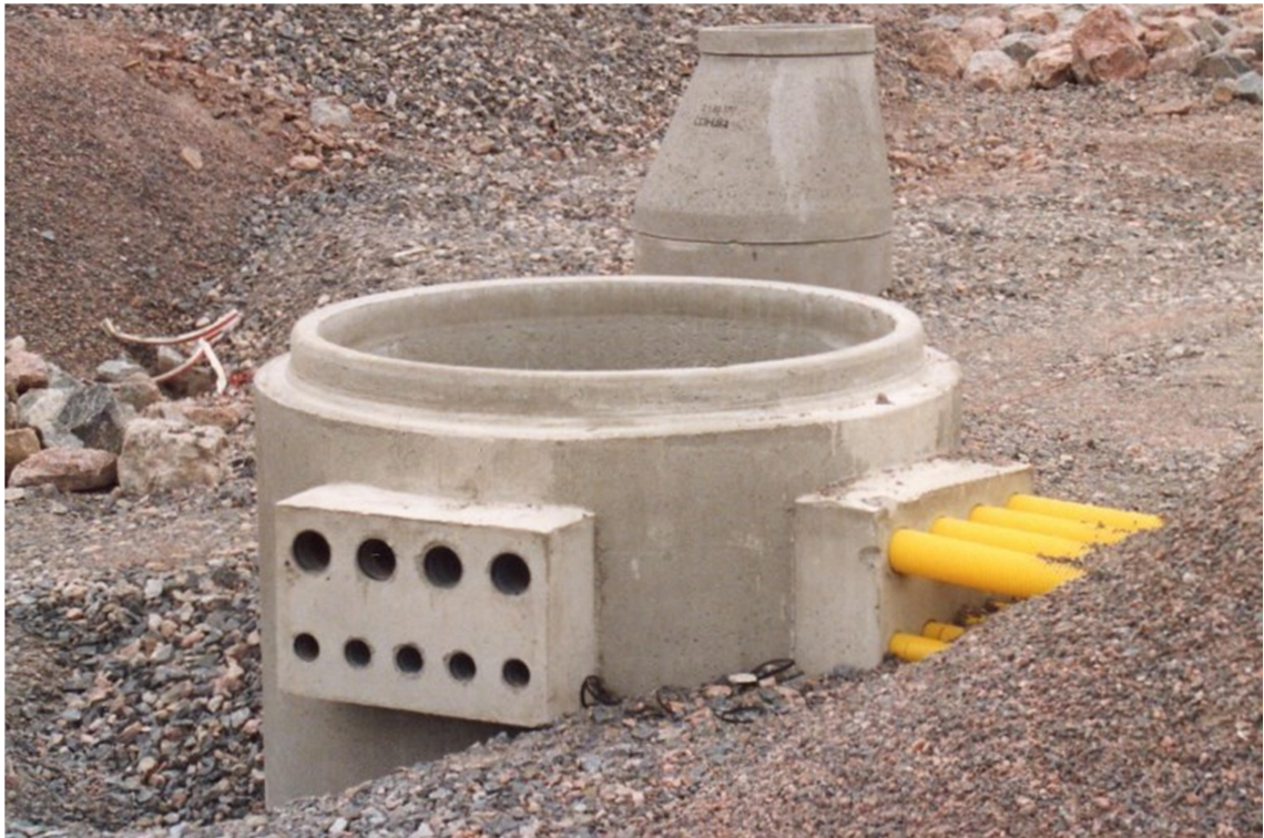
Kuva 2. Kaapelikaivo ja 110 mm:n kaapeliputkia (3).
