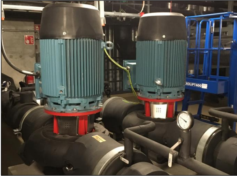
Kuva 12. Geo-piirin keskipakoispumput 4100PU01.1 ja 4100PU01.2.
