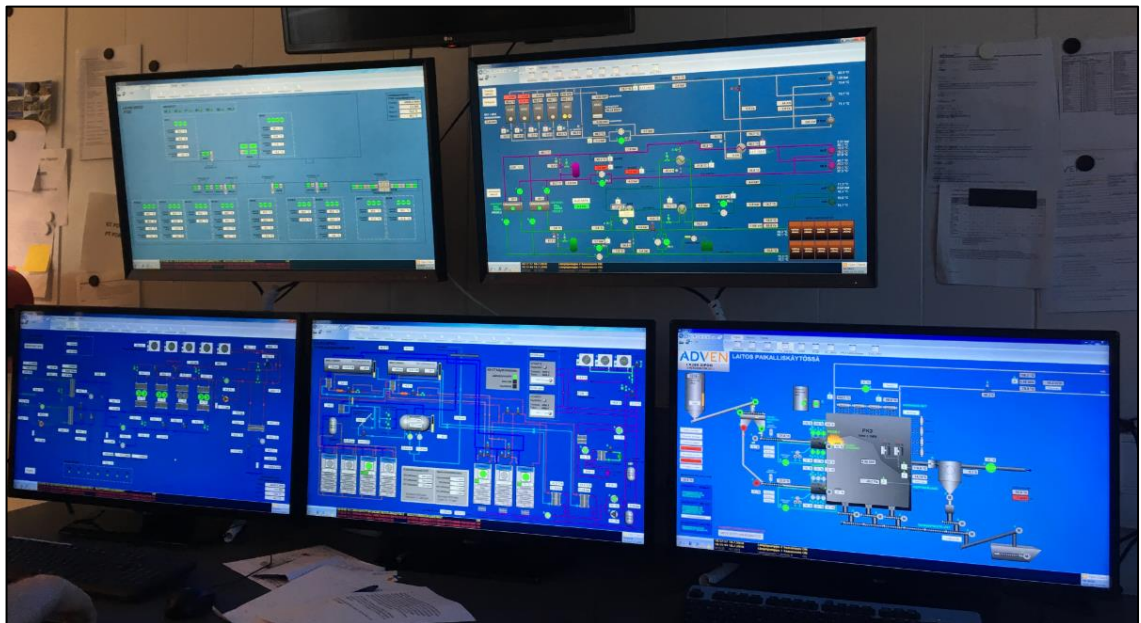
Kuva 13. Kuva laitoksen valvomosta.
