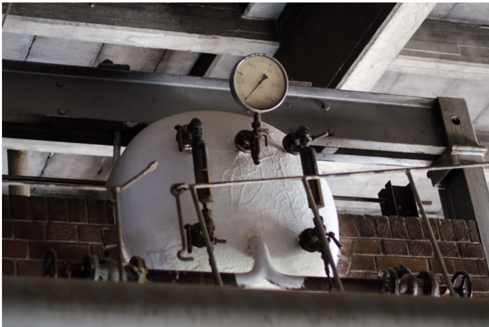
KUVA 28. Asbestieristys kattilan päädyssä (Pollari 2015).
