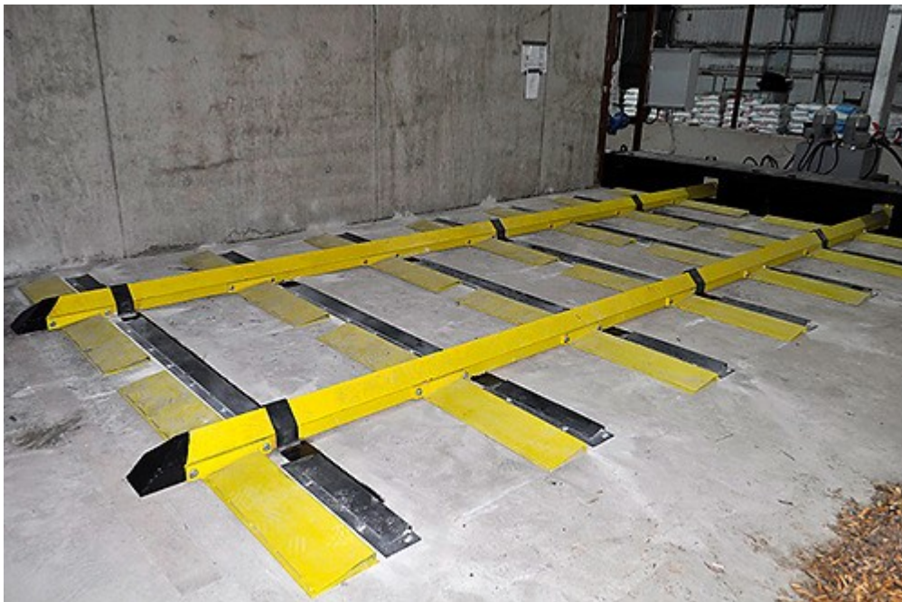
KUVA 7. Tankopurkainpohja. (NHK-Keskus Oy 2016).
