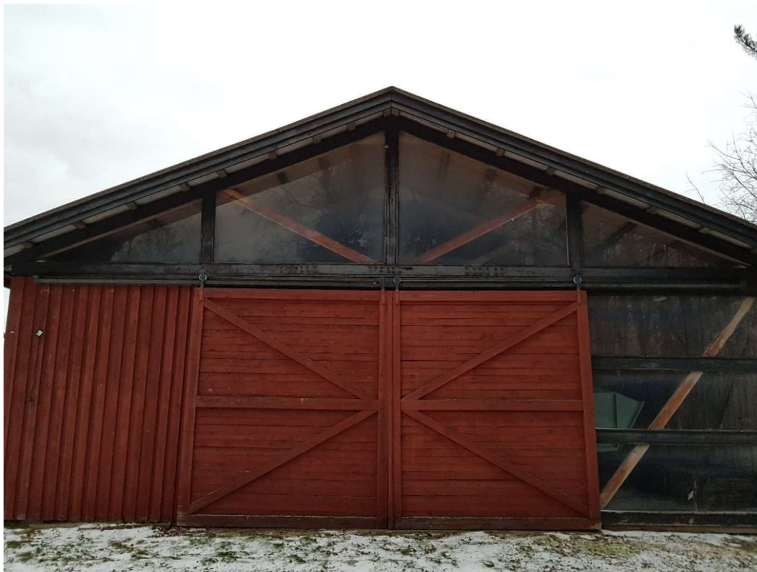
Kuva 2. Julkisivu länteen. Ulkoseinät lähellä maanpintaa, jossa nurmikasvillisuutta. Mahdollistaa puuosien kosteusvaurion.
