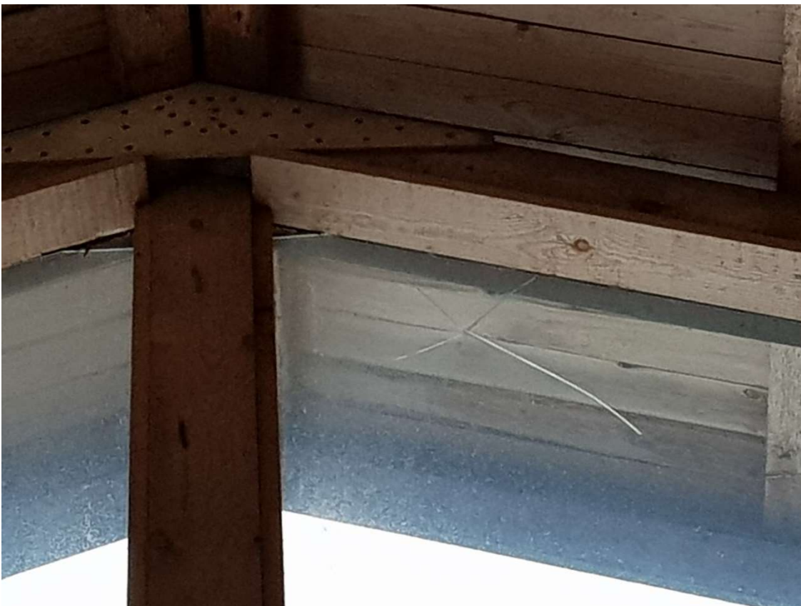
Kuva 14. Päätykolmion lasissa halkeama.
