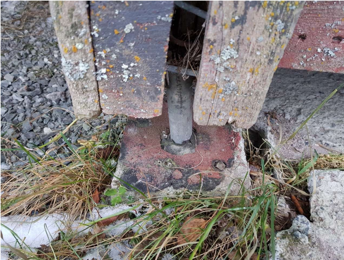
Kuva 9. Peruspilarin vedeneristyksessä vaurioita.
