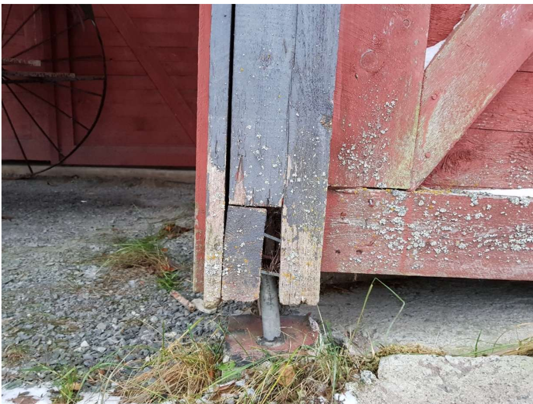
Kuva 8. Alapohjalaatan painuminen ja vaikutus pilariin.
