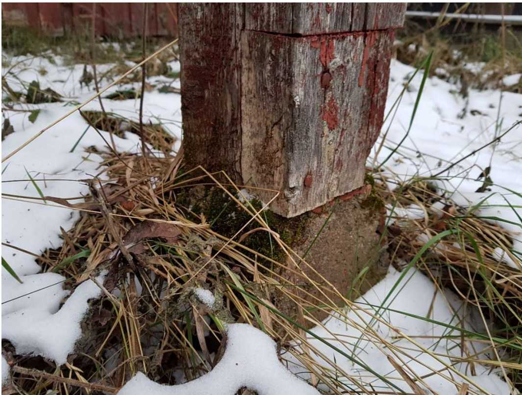
Kuva 7. Perus- ja puupilarin liittymän vaurio.
