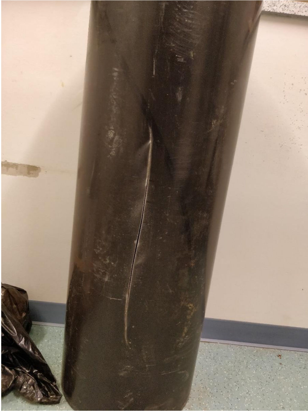
Kuva 4. 280 mm PVC-putki pitkittäissuuntainen halkeama, vuotomäärä n. 100 m 3 /h. Putki asennettu 1969, putkirikko 2016. (Pirainen 2019-05-10.)
