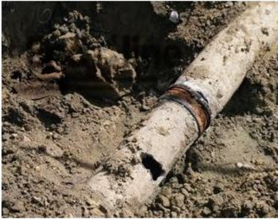
Kuva 1. Käyttökelvottomaksi vaurioitunut asbestisementtiputki (concreteconstruction.net).
