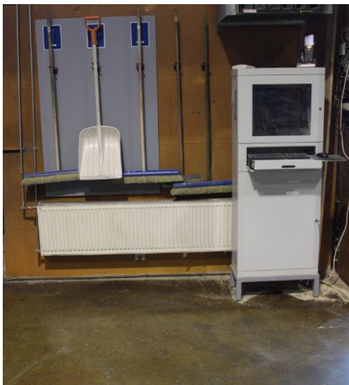
Kuva 7. Uusi laitekaappi ja siivousvälineiden säilytyspaikat.
