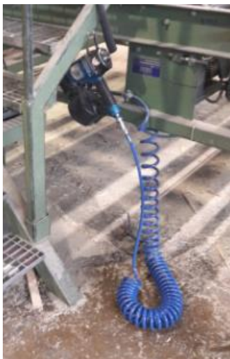
Kuva 13. Naulapyssyä varten asennettu kiinteä spiraaliletku
