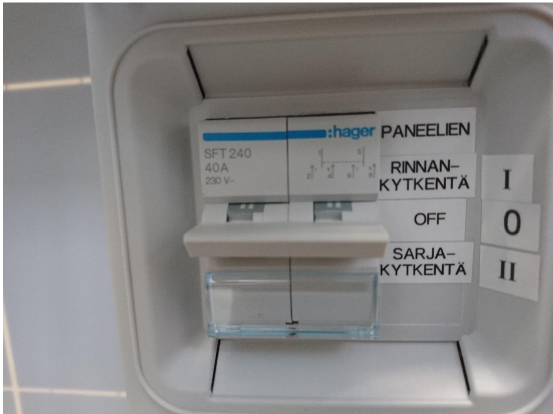
Kuva 12. Aurinkopaneelien rinnan - ja sarjakytkenän vaihtokytkin/erotuskytkin.
