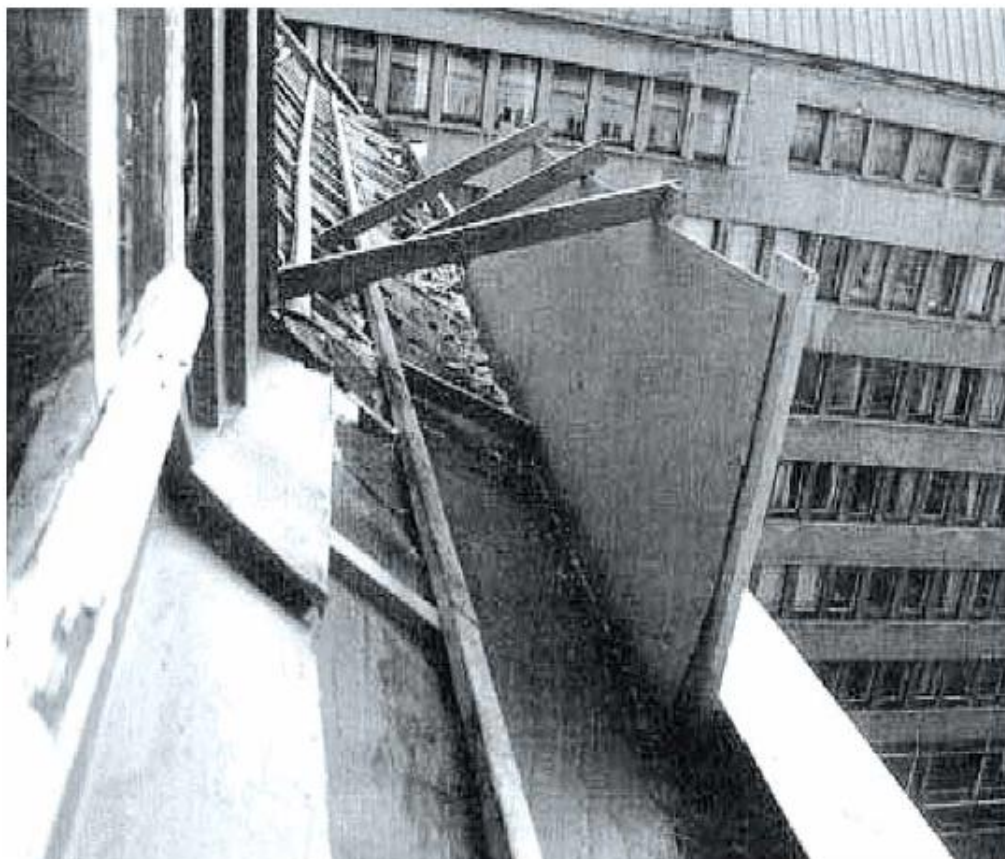
Kuva 5. Vasemmalla kulkuaukkona käytetty ullakkoikkuna. Oikealla tiliin pinoamisen käytetty tukilevy. Menehtynyt putosi kaiteettoman katon reunalta, jossa ei ollut edes tukilevyä.
