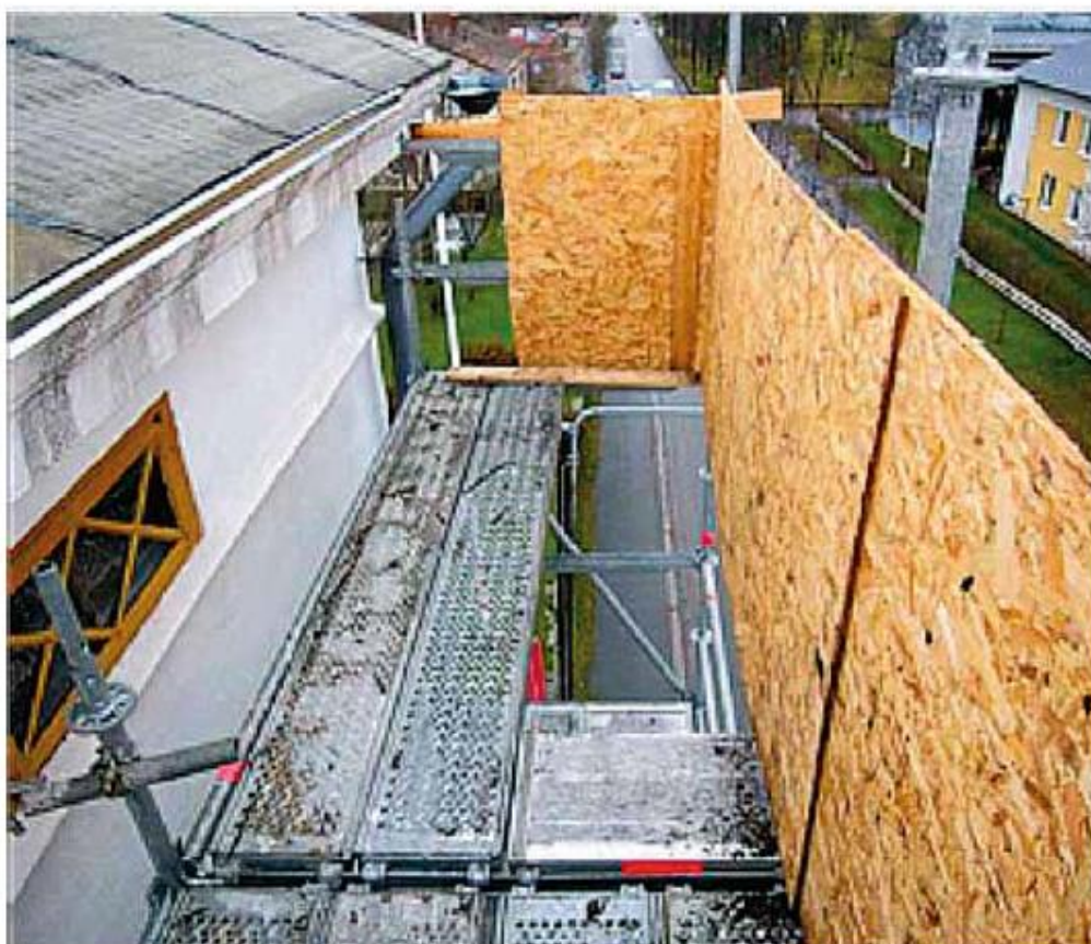
Kuva 4. Vasemmalla räystäs, johon telineeltä asennettiin räystäspeltiä. Keskellä suojaamaton aukko, johon yrittäjä putosi.
