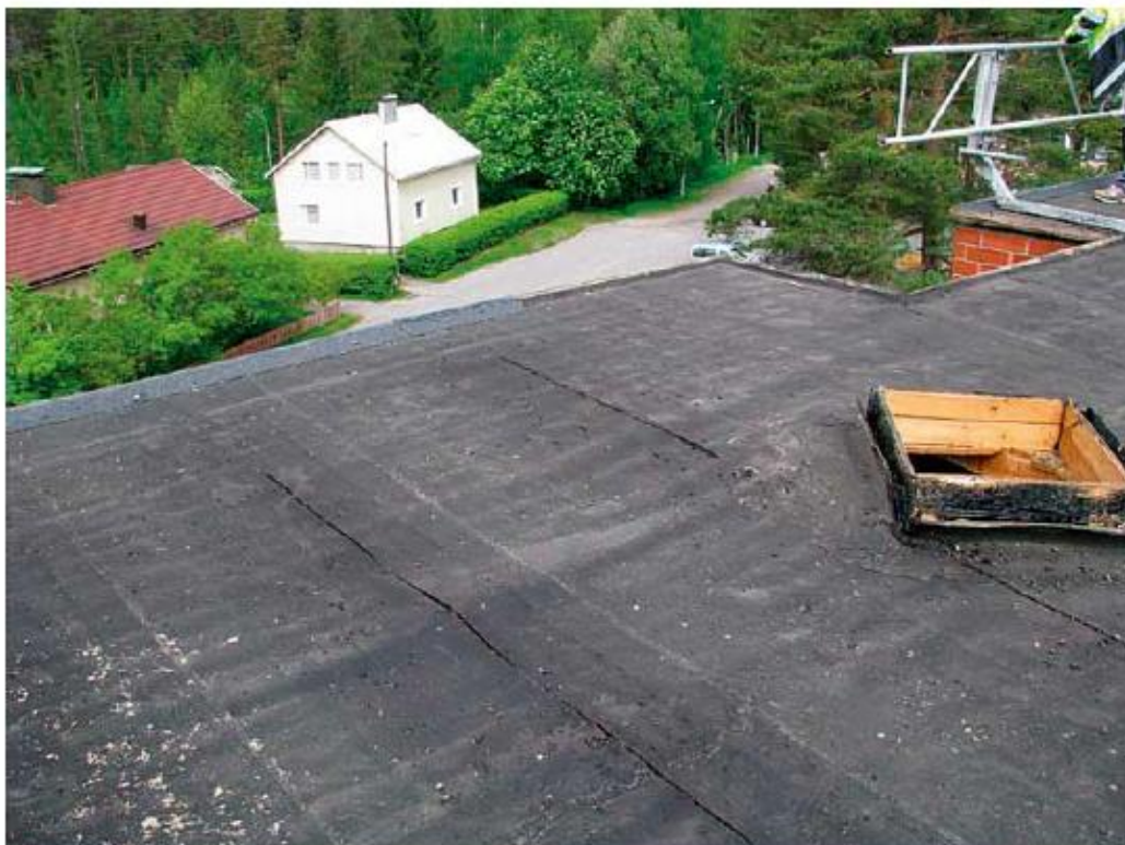
Kuva 3. NN oli vetänyt bitumileikkuria selkä edellä taustalla olevaa porrassyvennystä kohti ja pudonnut syvennyksen kohdalla maahan. Taustalla näkyy asennetun vastapainokaiteen pää. Kuvassa olevan läpiviennin reunukset ja aukko estivät tapaturmahetkellä leikkurin työntämisen.
