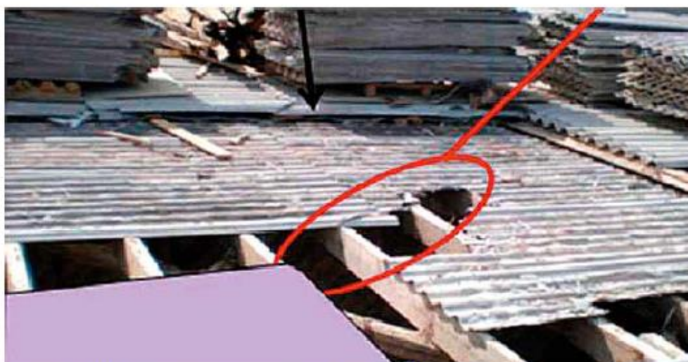
Kuva 2. Yrittäjä putosi uusittavan katon lävitse 20m matkan hallin lattialle.
