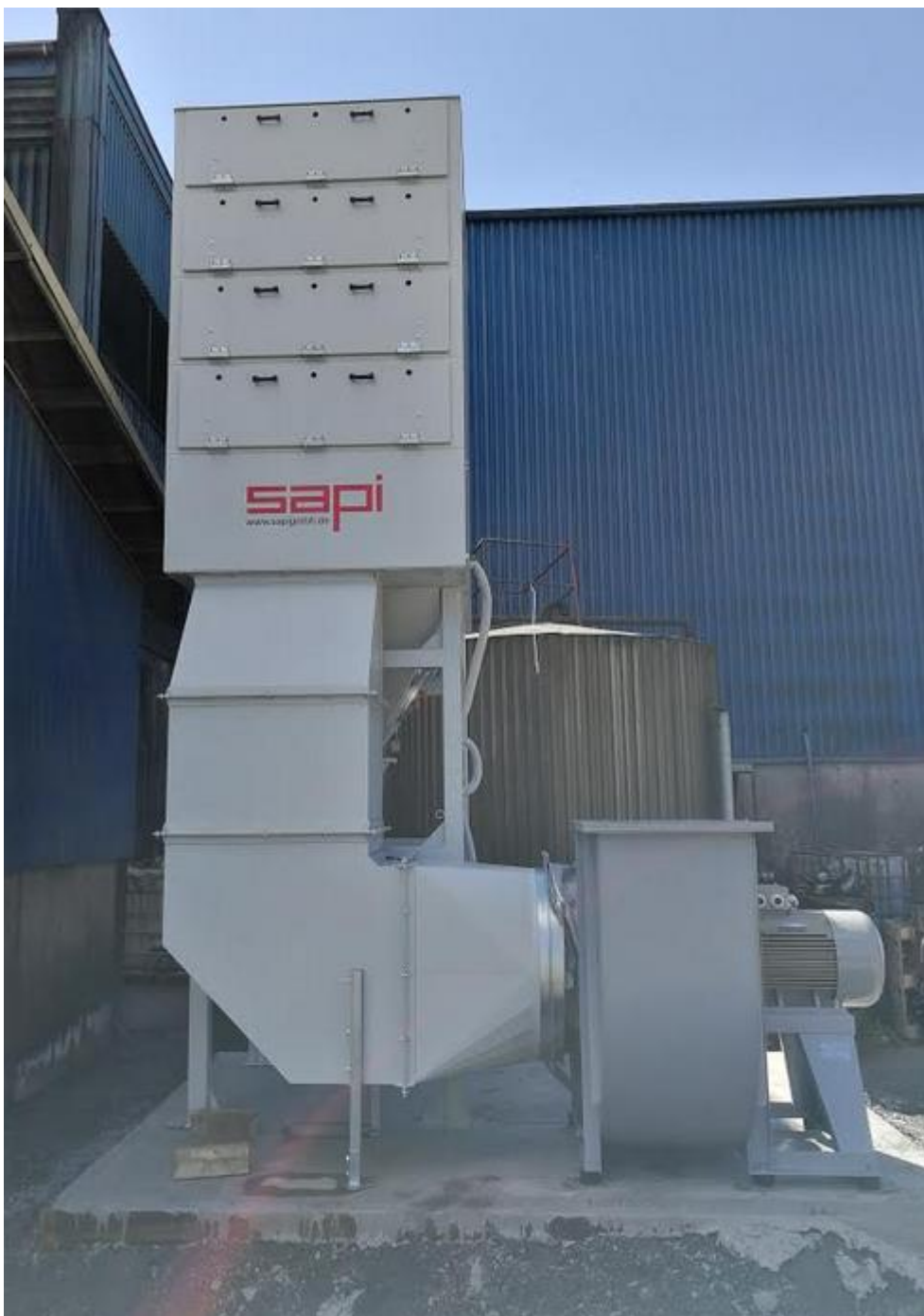
KUVA 3. Valmis asennettu suodatinyksikkö
