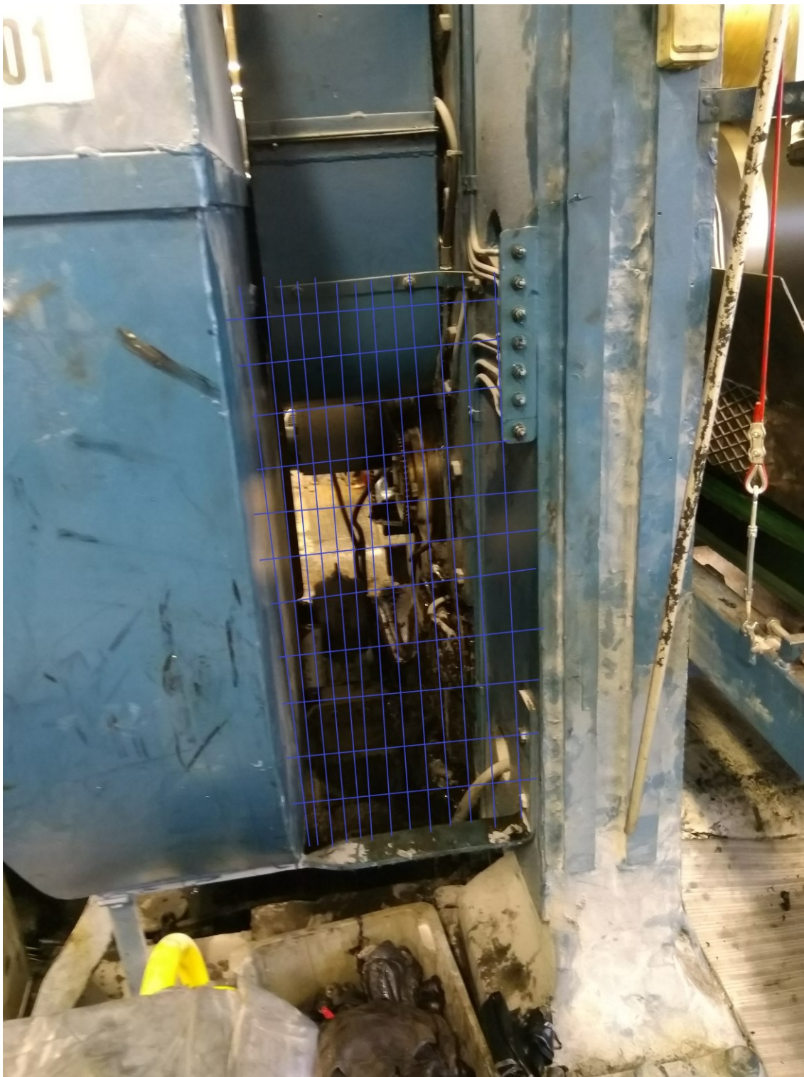
KUVA 9. Suojaamaton liikkuva koneenosa. Työntekijän täytyisi nähdä suuresti vaivaa vahingoittaakseen itseänsä. Myös tämä vaarataso voidaan arvioida vähäiseksi. Halutessa koneen liikkuvat osat voidaan suojata eteen laitettavalla verkkoaidalla. Vaara on kuitenkin siedettävä ja siten myös suojaustoimenpide valinnainen.
