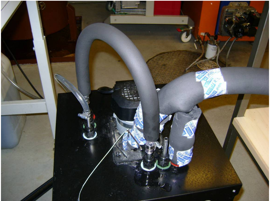
KUVA 12. Tuoteputkien kytkeminen sarjaan
