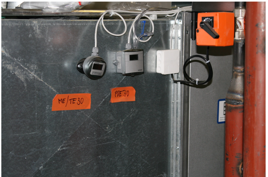
Kuva 23. Ilmanvaihtokoneen työnaikaisia merkintöjä, Codel.
