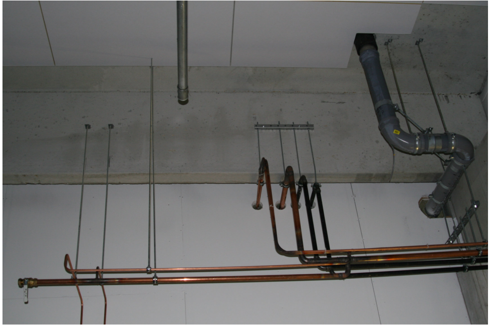
Kuva 24. IV-konehuoneen vesi- ja viemäriputkien kannakointeja, Codel.
