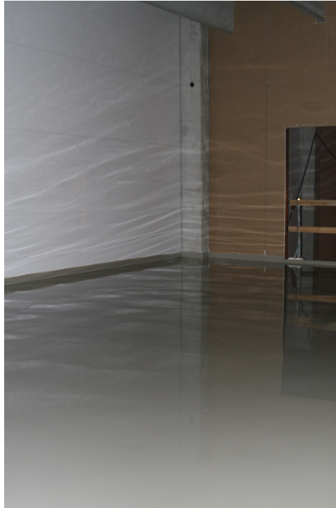
Kuva 11. Tyhjä IV-konehuone, Codel.
