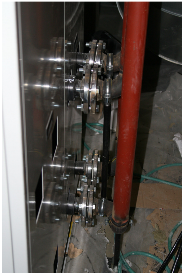
Kuva 25. Vedenjäähdytyskoneen kytkentöjä, Codel.
