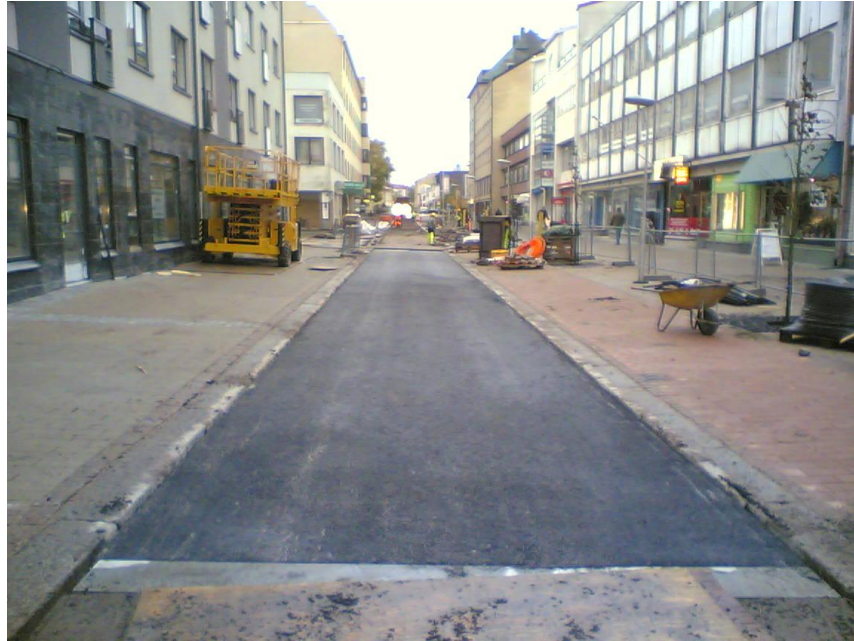
Kuva 10. Ajorata on saanut asfalttipinnan
