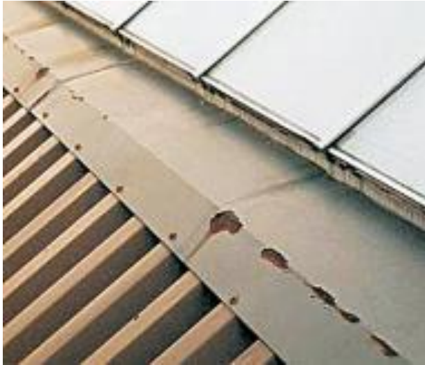
KUVA 6. Pellityksen kolhiintumisen aiheuttamaa korroosiota (12, s. 5)
