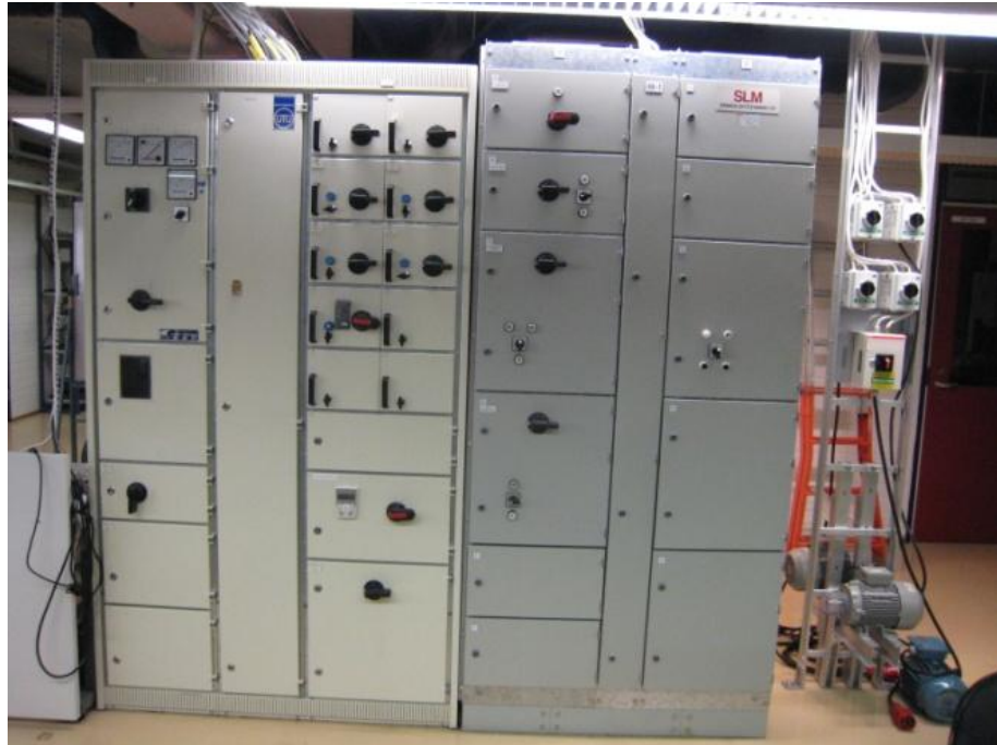
Kuva 12. Sähkövoimatekniikan laboratorion opetuslaitteita: moottorikeskuksia
