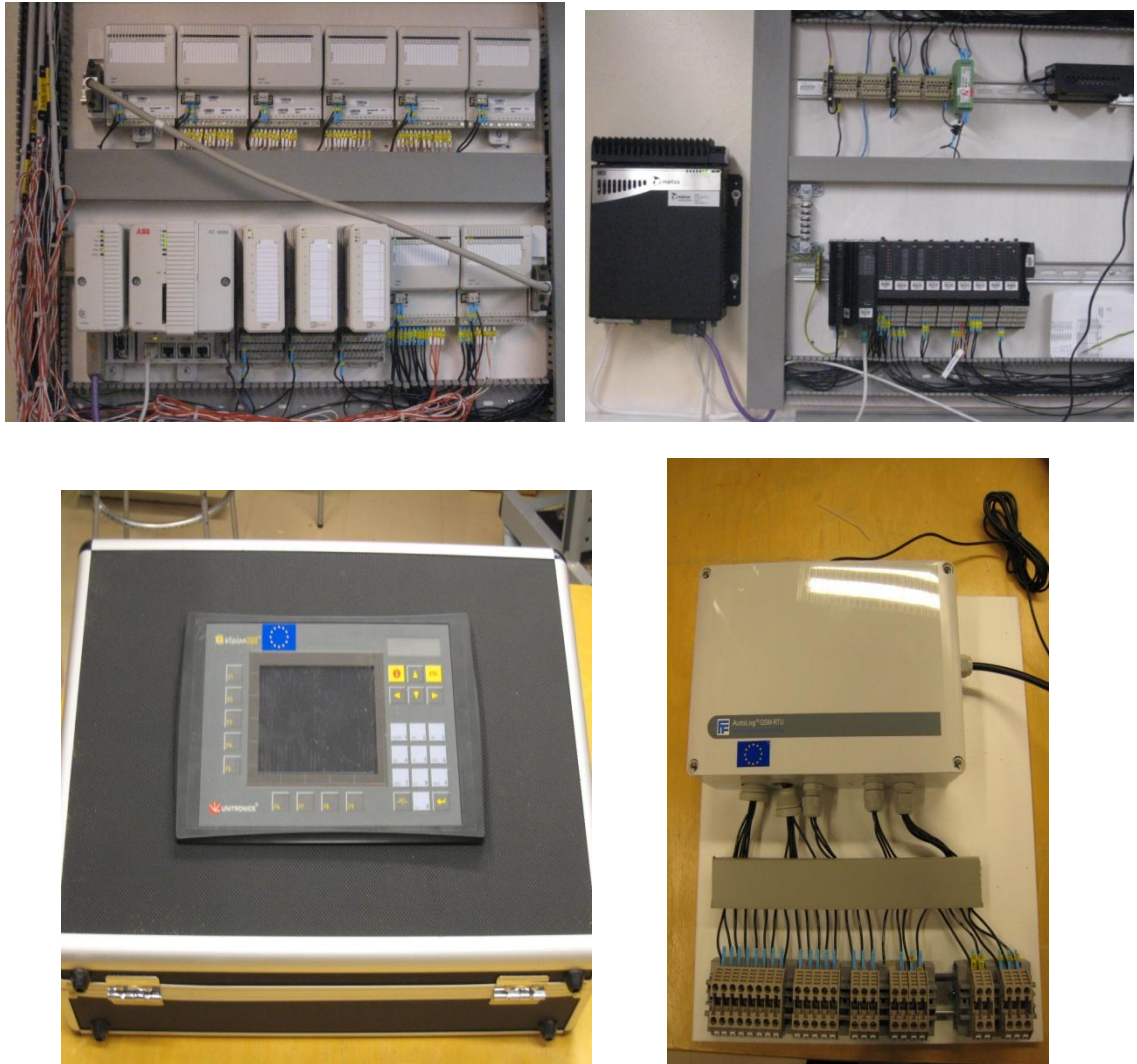
Kuva 31. Automaatiojärjestelmät (ABB, Metso) asennettuna seinälle ja oppilaiden käyttöönotettavia ohjelmoitavia logiikoita (Vision ja Autolog) asennettuna salkkuun ja puulevyllä /15/
