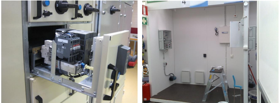
Kuva 40. Opetusprosessit: a) Sähkömoottorilähtö b) Ouman EH60, sähkökeskus, sähköpatterit tms. (liite 7) monimutkaisempana kokonaisuutena
