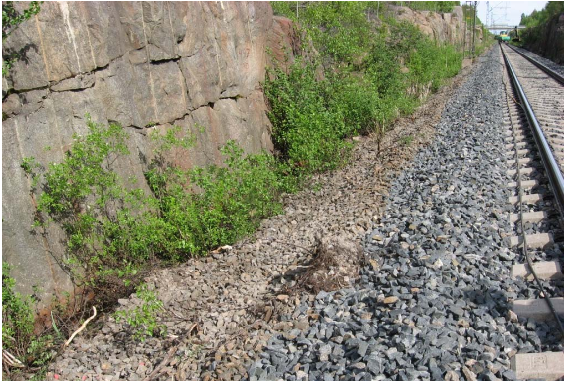
Kuva 10: Radan kallioleikkauksen kuivatusojassa kasvillisuutta ja tukikerrosmateriaalia
