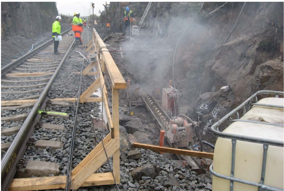
Kuva 28: Suojakaide porauspoteron kohdalla
