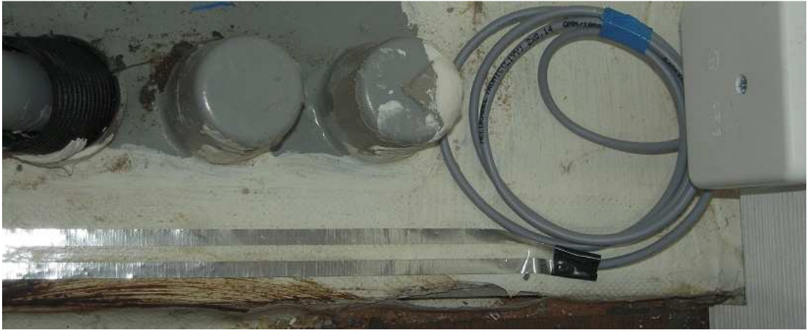
Kuva 59. Jakotukin vesivuotovalvonta toteutettuna teippianturilla.
