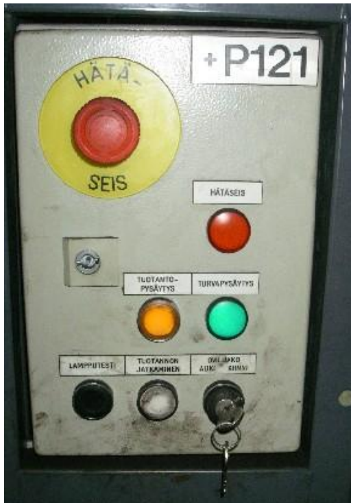
Kuva 6. Turva-alueen oven avauskytkinlaatikko /5/
