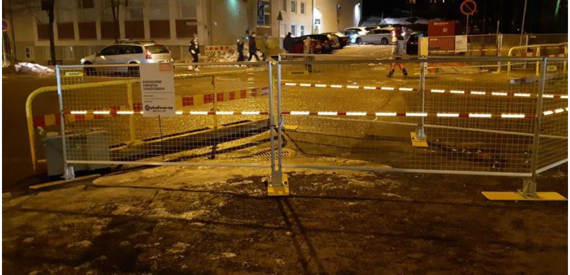
Kuva 3. Safepass GC barrier system -työmaa-aita.
