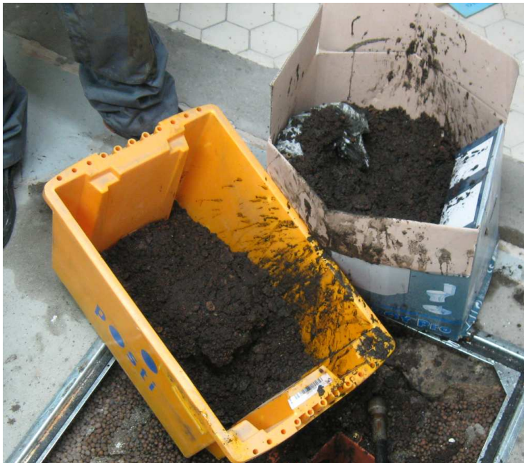
Kuva 7. Sadevesiviemäristä puhdistuksessa irronnutta ruostetta [22].
