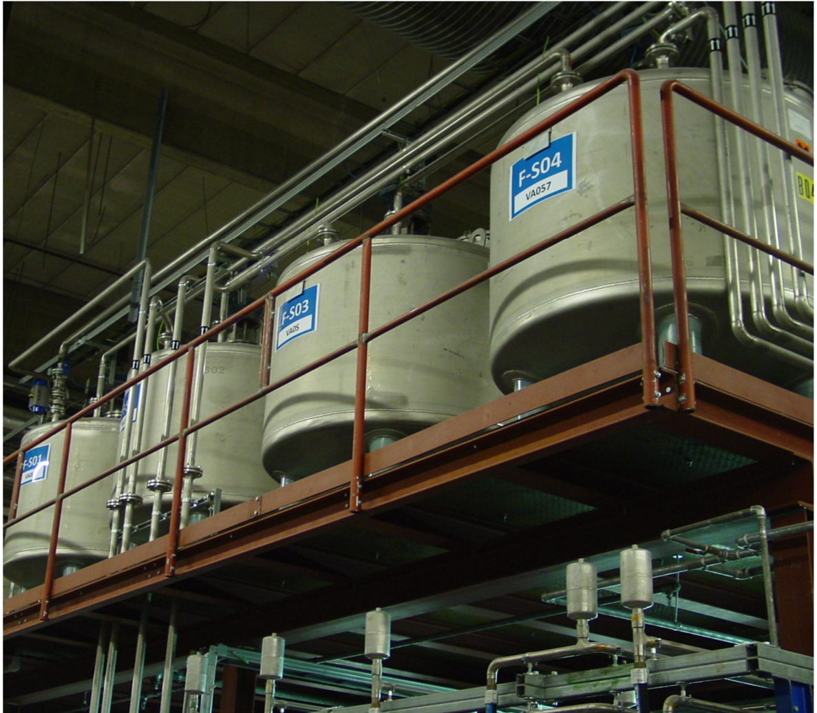
Kuva 5: A-hallissa sijaitsevan Füll-laitteiston ylätasanteen säiliöihin asennetut uudet A3-kokoa olevat kyltit.
