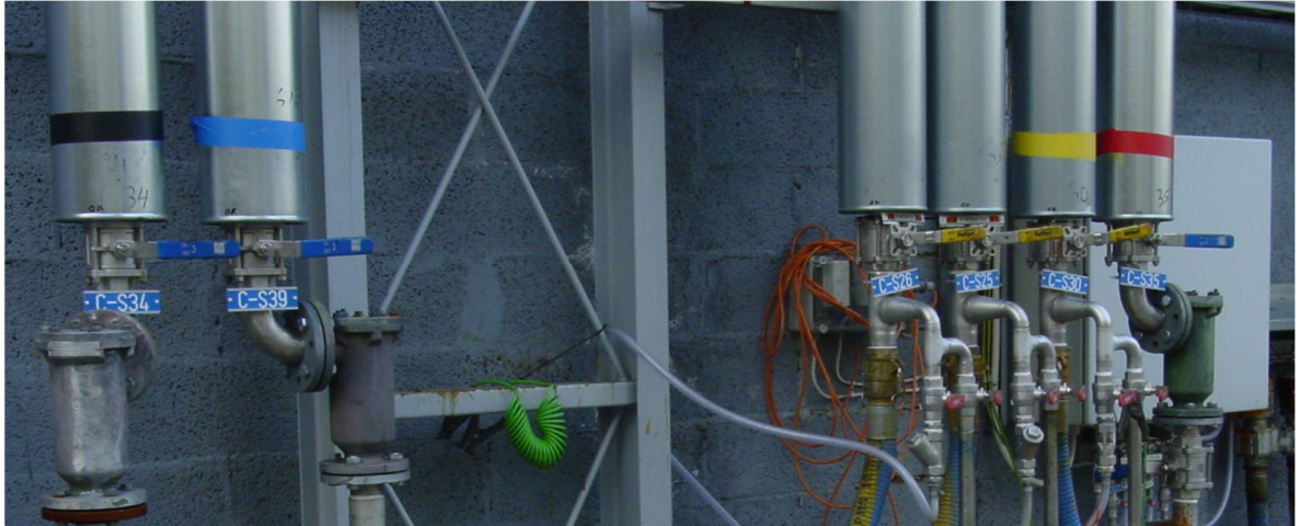
Kuva 7: Esimerkki uusista merkinnöistä ulkoasennuksessa. Kyseessä on ulkona oleva syväpainovärien ja vernissan lastauspiste.
