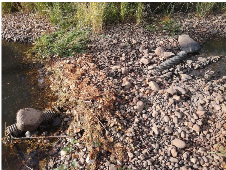
Kuva 7. Heikosti rakennettu pintapato, joka on painunut 50 cm alkuperäisestä korostaan. Pato on kokenut eroosiota, se vuotaa, sen putki on tukkeutunut ja kalat pääsevät uimaan sen lävitse kosteikolle (Sihvo 2018)
