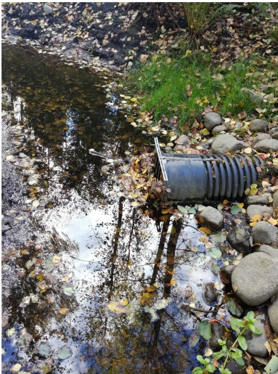
Kuva 1. Tukkeutunut poistoputki, jonka seurauksena laskeutusallas tulvii kovemman sateen aikana yli penkereen. (Sihvo 2018)
