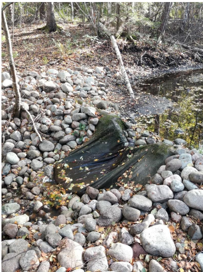
Kuva 5. Thomsonin pato, jossa havaitaan kivien siirtyminen kevättulvan seurauksena (Sihvo 2018)
