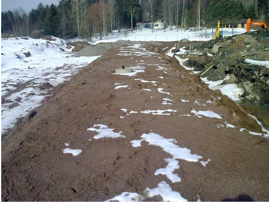
Kuva 22: Sipoon-rannan tiepohjan painumapenger, Sipoo.
