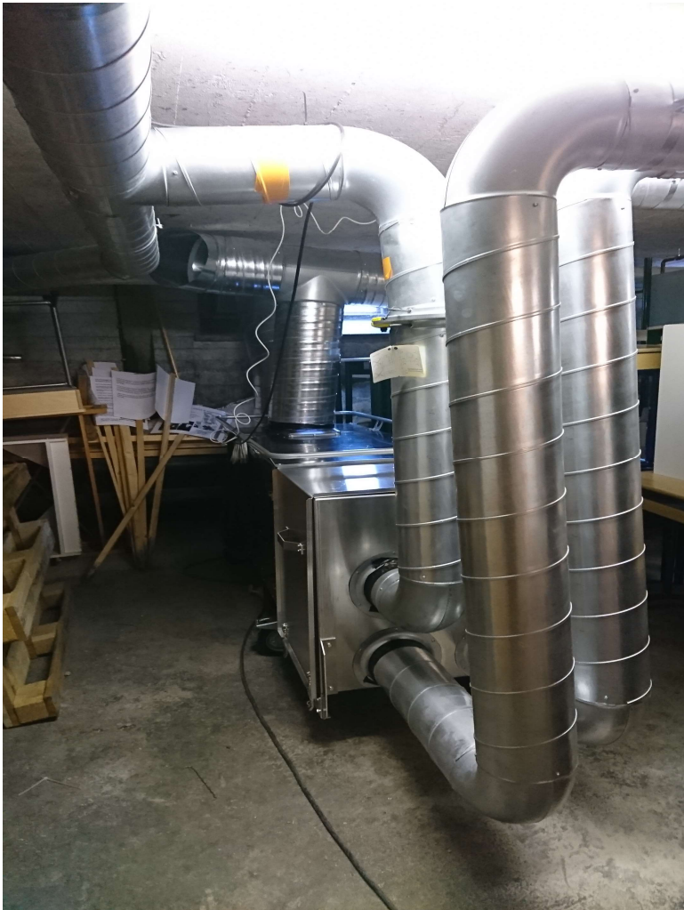
Kuva 14: Kauttuan koulun kellarin Apad-alipaineistus (oma kuva-arkisto)
