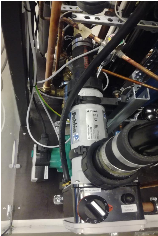
KUVA 7. Sähkövastus, jolla tuotetaan kylmäkoneen lämpökuorma
