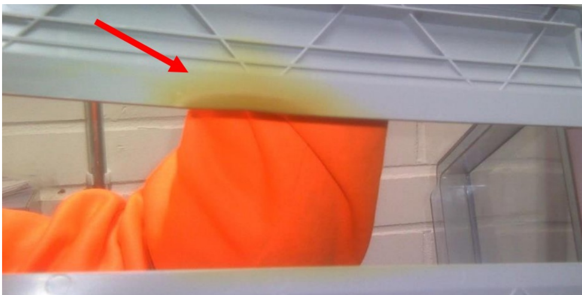
KUVA 16. Lämpövauriot kosketussuojassa (Ari-Pekka Alatalo 2019)
