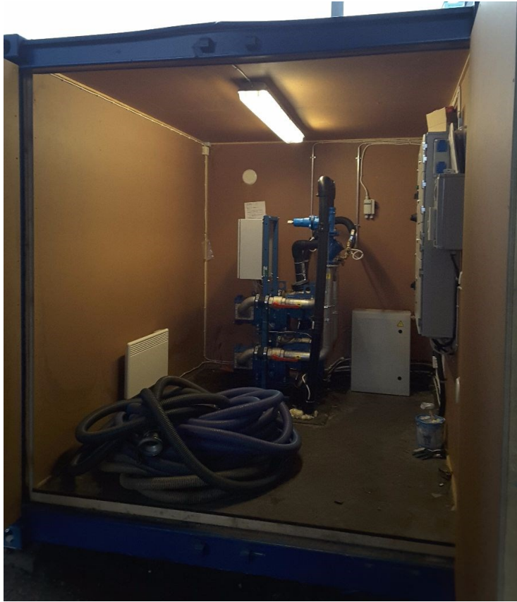
Kuva 6. Jäteveden imutyhjennysjärjestelmän kontti, jossa sijaitsevat toimintavarmuuden vuoksi kahdenkertainen lieteimurit ja liityntä kunnalliseen viemärijärjestelmään.
