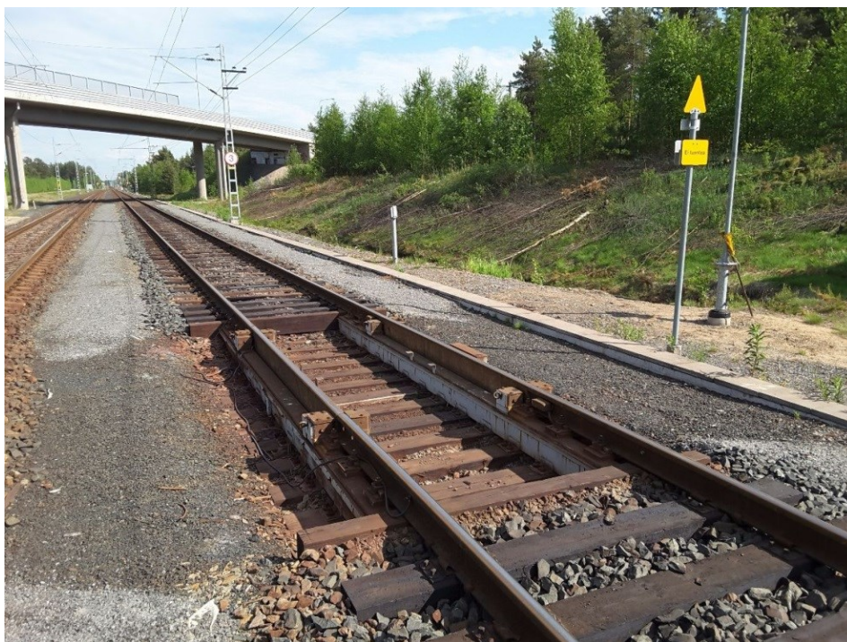
Kuva 9. Vaunut ajetaan vaakaa koskevan nopeusmerkin sallimaa enimmäisnopeutta vaa'an yli. Kuvan vaaka kykenee punnitsemaan kaksiakselisen vaunun yhteen akseliin tai neliakselisen vaunun yhteen teliin vaikuttavan massan kerrallaan.
