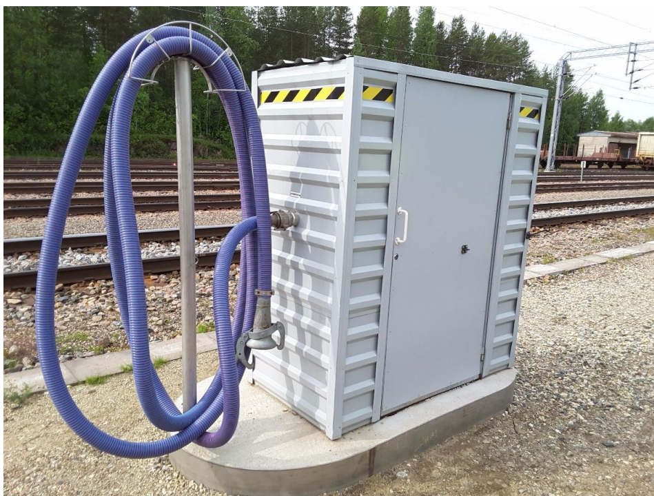
Kuva 5. Kajaanissa sijaitsevan yhteiskaapin jäteveden imutyhjennysjärjestelmän letku.
