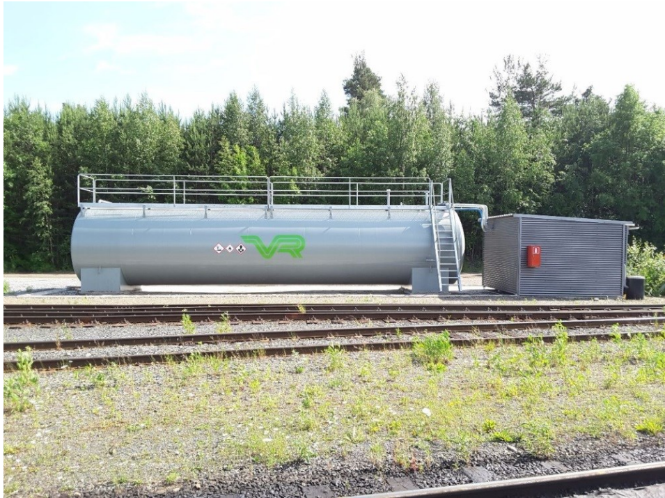
Kuva 8. Nykyinen Joensuussa sijaitseva polttoaineen varastosäiliö. Varsinainen tankkaus tapahtuu erillisessä vetokaluston ajovalmius-huoltorakennuksessa.
