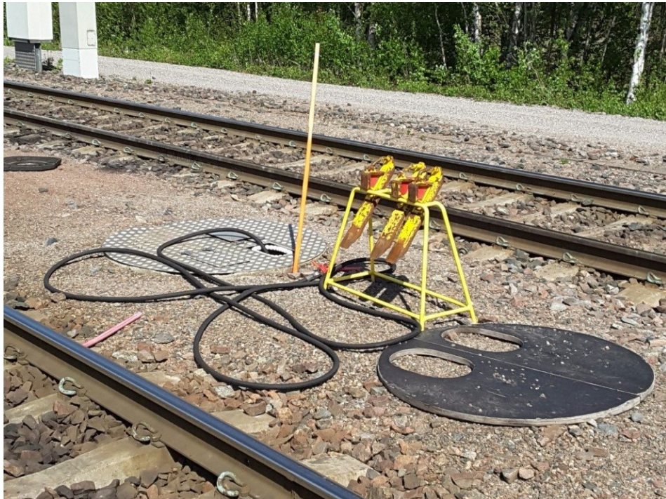
Kuva 11. Jarrukoettelujärjestelmän letkukaivo. Kaivoissa sijaitsevat letkukelat ovat erityisesti talviolosuhteissa hankalia käsiteltäviä.
