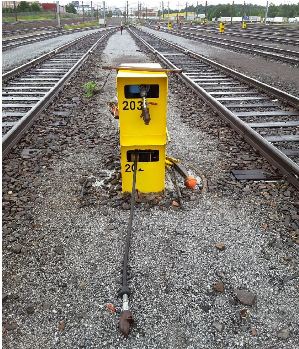
Kuva 12. Ergonomisempi vaihtoehto on tuoda letkuketat ylös kaivoista letkukaappiin tai tilan salliessa erillisiin ylösnostettuihin letkutilppiin.
