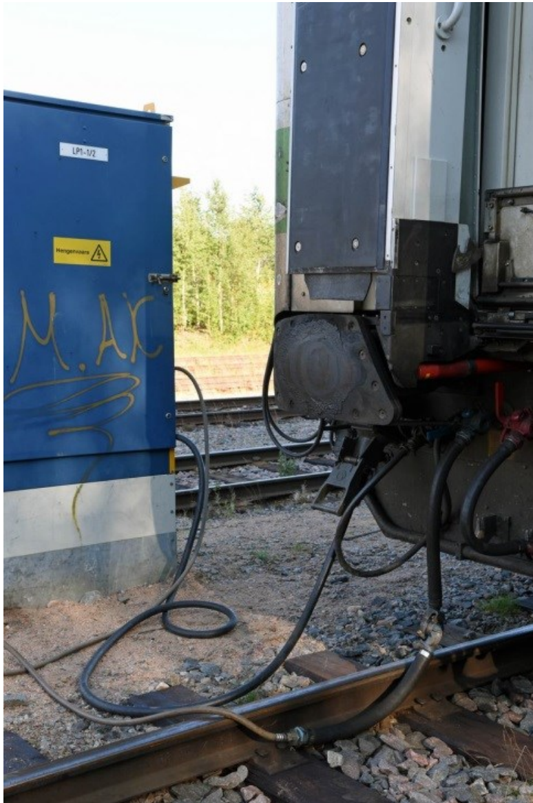
Kuva 3. Paineilmaa syötetään ratapihalla matkustajavaunujen huolto- raiteiden läheisyydessä sijaitsevasta paineilman runkolinjan lii- tätänpisteistä junan läpi kulkevaan pääsäiliöjohtoon (siniseen hanaan johtava letku kiskon vieressä).
