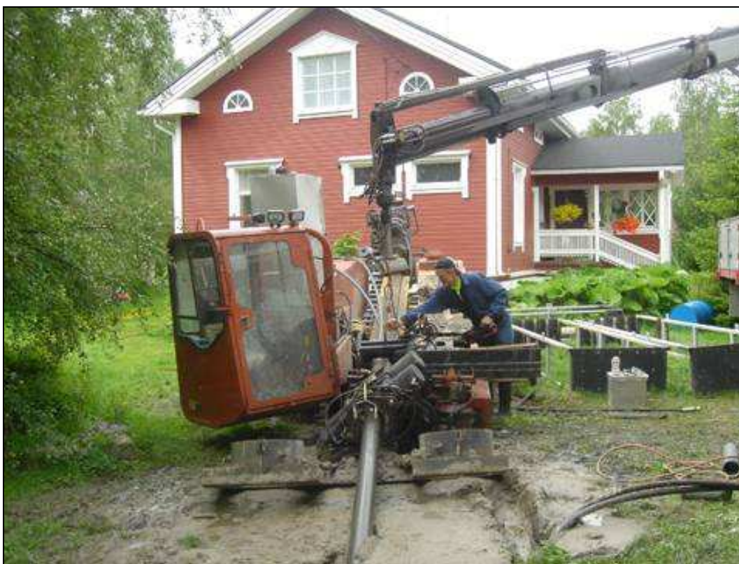
Kuva 4.3. Maalämpöputken syöttö. (Vaakaporauspalvelu Oy).
