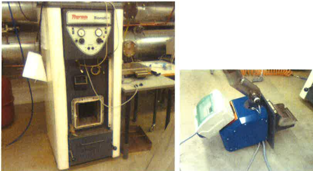
Kuva 2. Oamk:n Tekniikan yksikön pienkattila (20 kW) ja kuppimallinen pellettipoltin.
