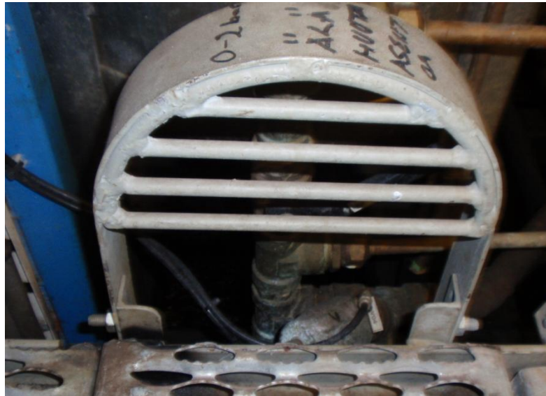
Kuva 11. Mittauspään paineen sekä virtauksen säätöventtiili.
