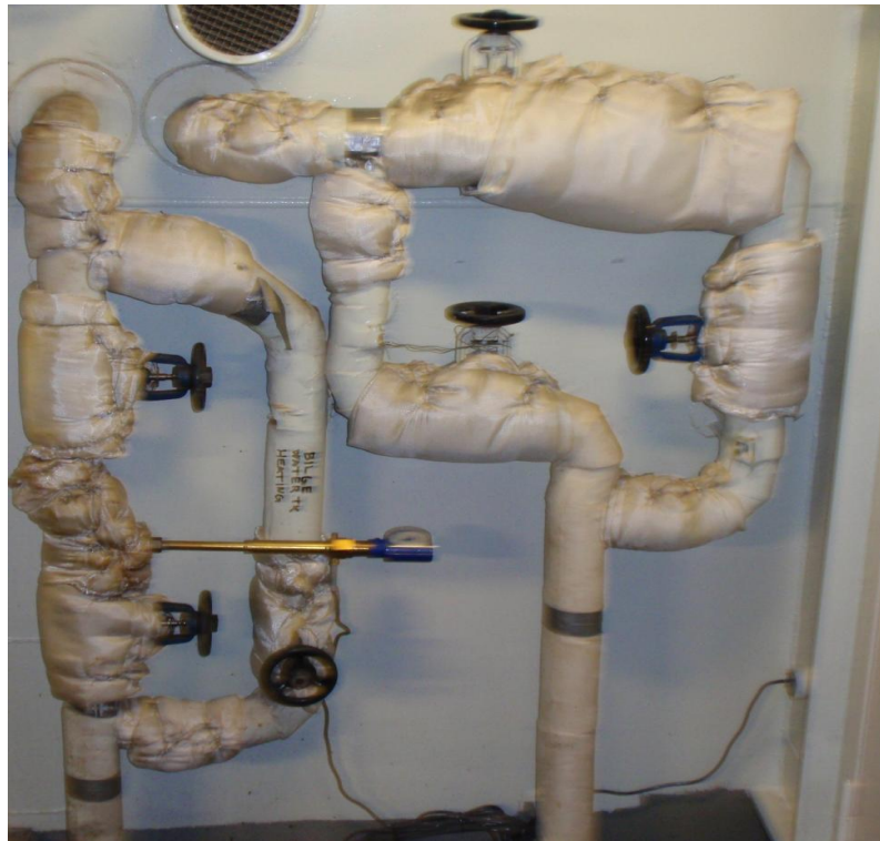
Kuva 13. M/S Finnlady'n pilssivesitankin lämmityslinjan putkistoa 2010
