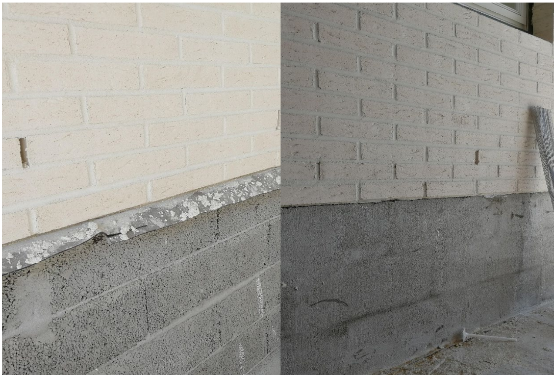
Kuva 31. Kuva porttikongin sokkelista. Vasemmalla oikein tehty vesieristysten keskeytys, oikealla väärin (30.7.2018).
